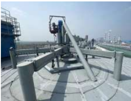
筒仓顶部进料口设备
