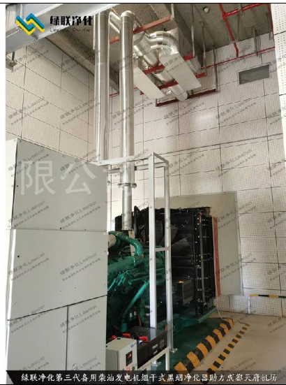
绿联净化第三代备用柴油发电机组干式黑烟净化器助力成都天府机场
