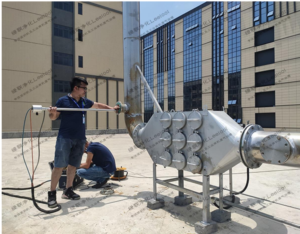
长安某港企新建发电机房 | Dorman500kW 柴油发电机组降噪及黑烟治理
